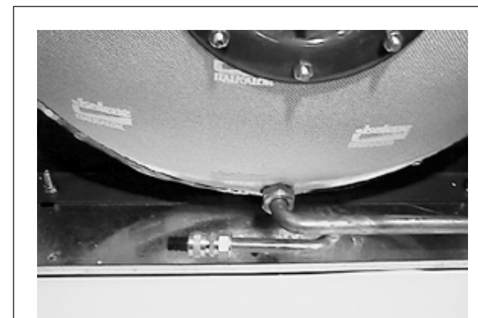
Foto C: Rubinetto di scarico bollitore Foto C: Llave vaciado del hervidor
